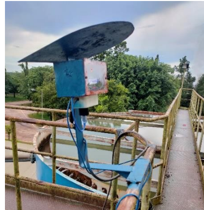
Gambar 3.3. Peletakan alat monitoring Di WTP
