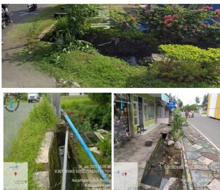
Gambar 10. Kondisi saluran di Jl. A. Yani tidak hujan
