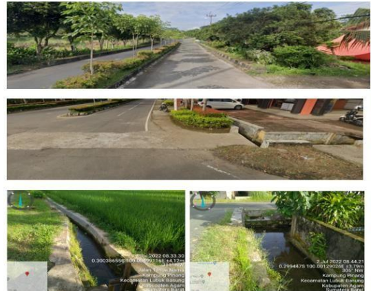
Gambar 11. Kondisi saluran di kawasan Sport center tidak hujan
