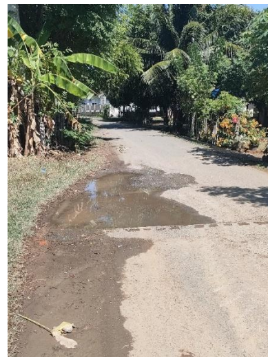
Gambar 27. Gambar Jalanan Berlubang (Sumber: Dokumentasi Pribadi)
